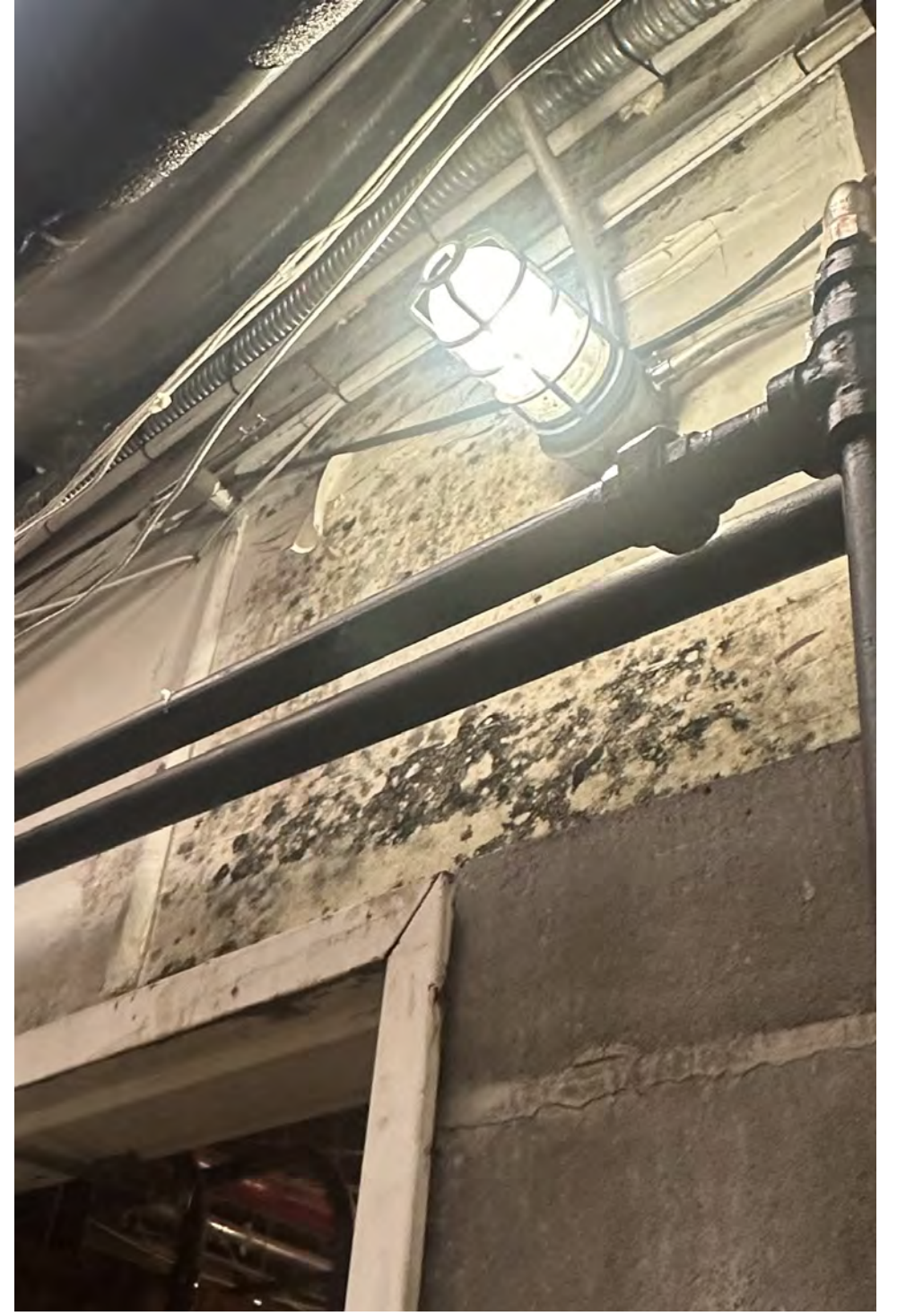
27 MOLD DAMAGE Scale: NTS
