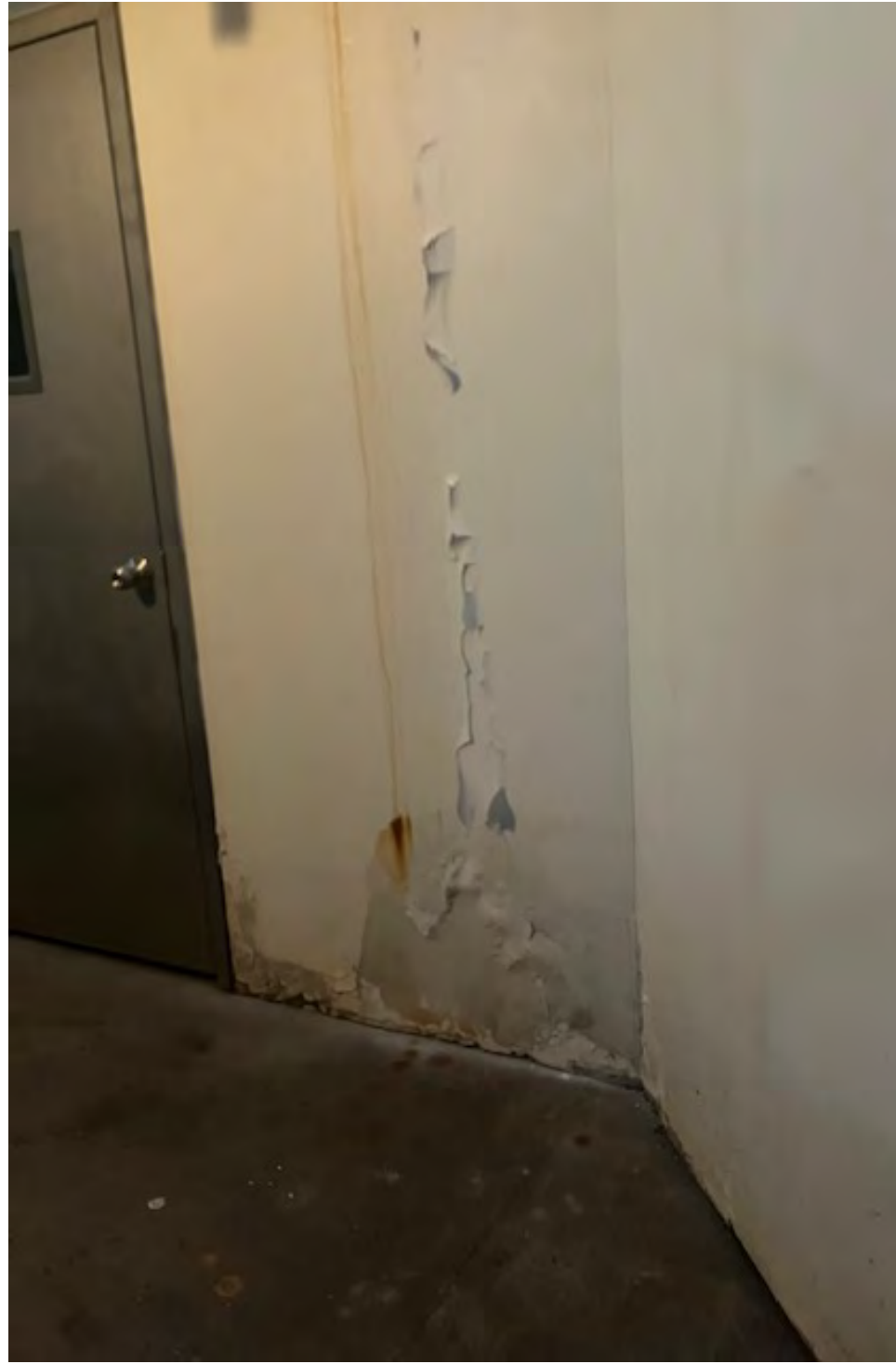
26 MOLD DAMAGE Scale: NTS
